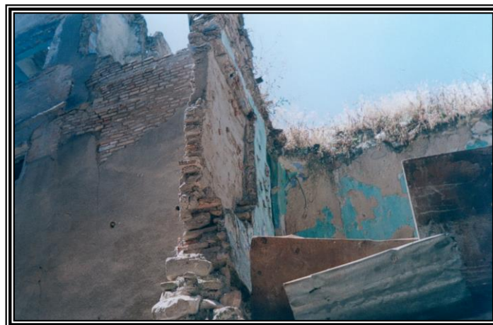
Fig. 19 : Etat dégradé d'une maison se trouvant à Houmet Et-Tebbala
