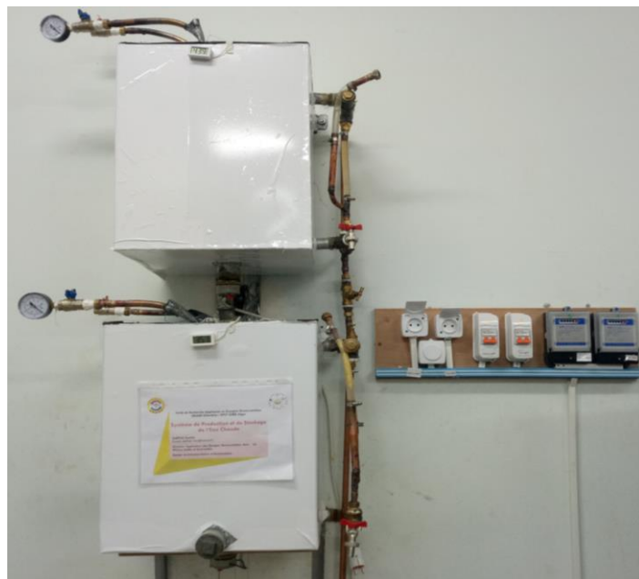
Figure 4.4: Vue générale sur le système réalisé sur la disposition et l'emplacement des cuves réalisées
