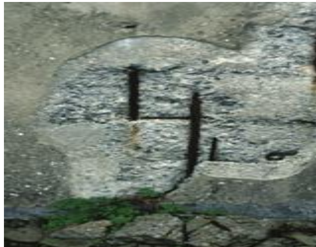
Figure (I.10): Exemple de dégradation du béton.
