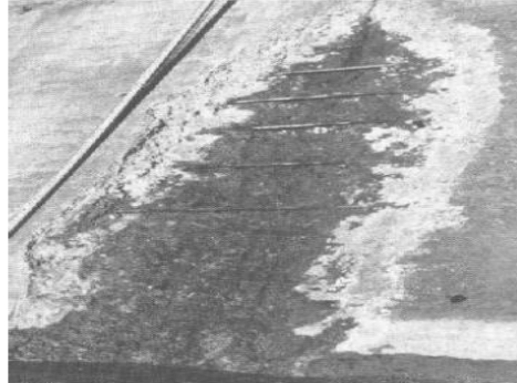
Figure (I.16): Béton détérioré par une attaque par les sulfates - Barrage Fort Peck sur la rivière Missouri au Montana [94].
