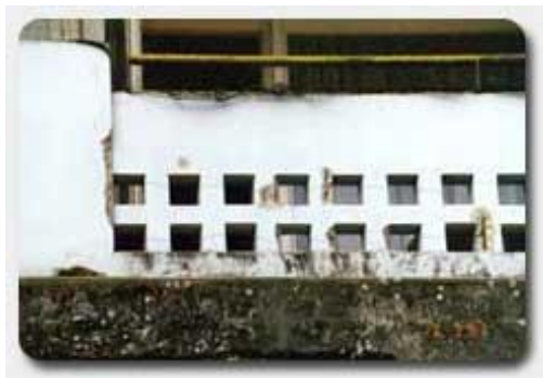
Figure 6 : Carbonatation et éclats de béton dus à la corrosion des aciers [39]
