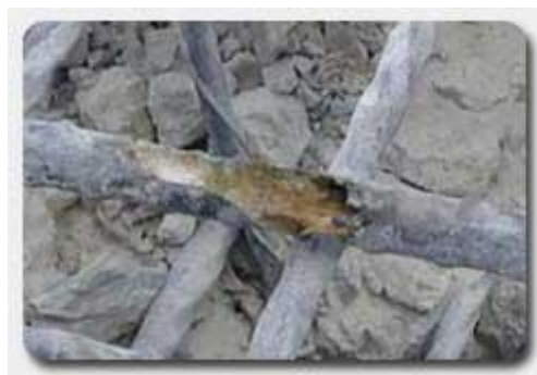
Figure 10 : Piqûres des aciers avec forte diminution de section (Pont près de Vallorbe, VD Suisse) [41]
