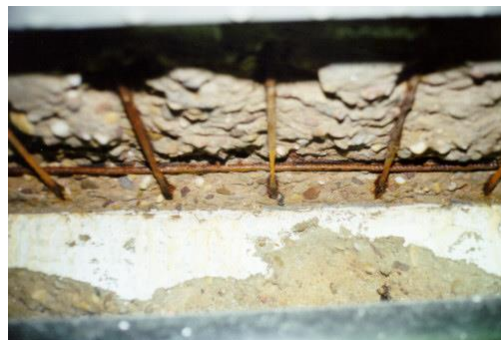
Figure 7 : Armatures localement fortement corrodées [39]
