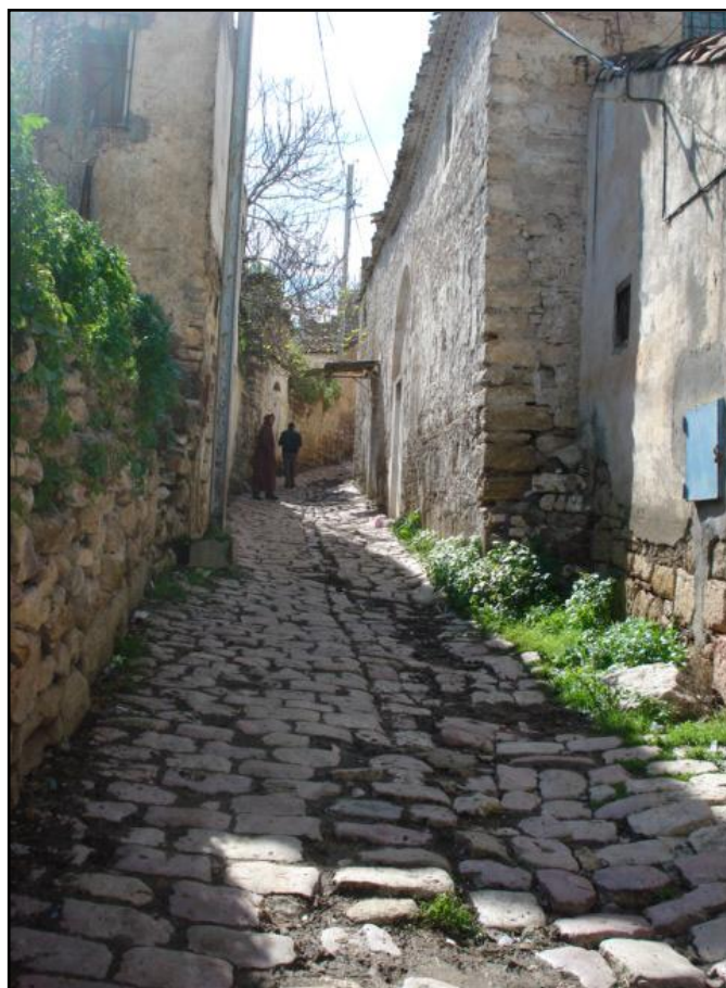
Photo n° 20 : Vue sur une ruelle : Le pavé est dégradé, mais les murs sont conservés, nous avons un traitement de façade typique : pierre et briques intercalées.
